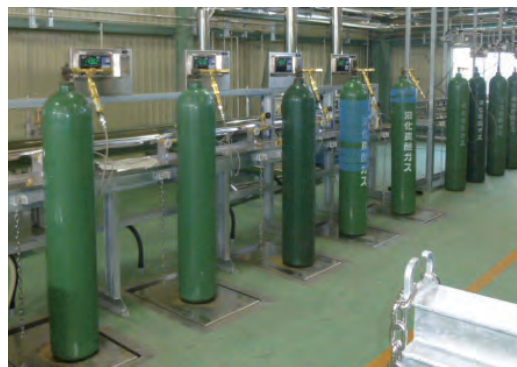
ガス再生・充填施設
